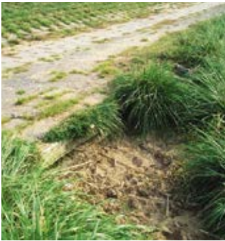
Erosion an Einbauteilen
